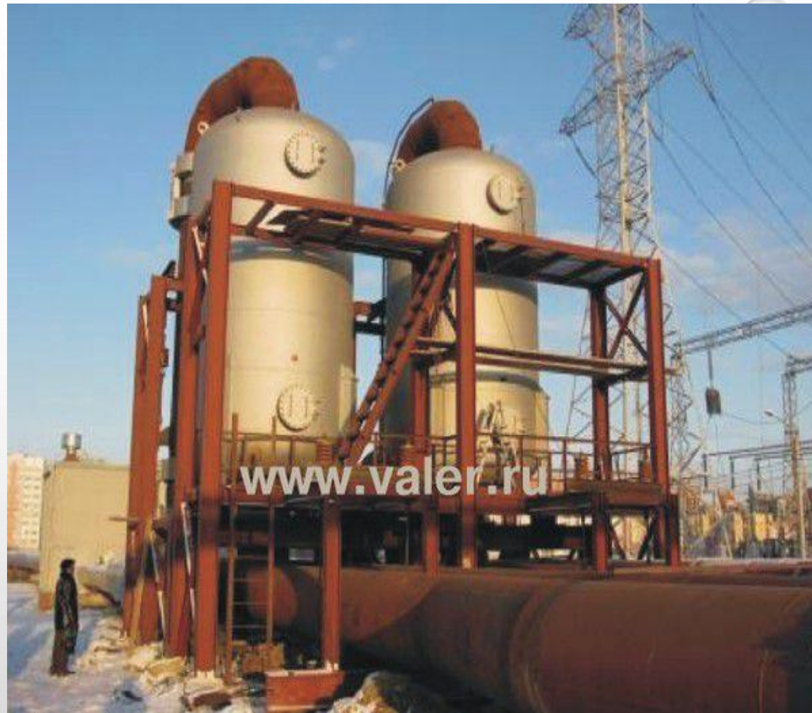
Фильтры-грязевики ГИГ-6000 ВК. Установлены в 2009 г. на Приморской котельной Санкт-Петербурга.
