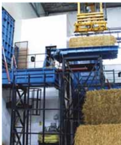
Рисунок 2.28 – Котельня, що працює на соломі
