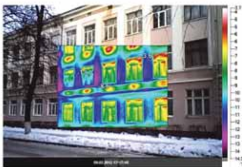
Рисунок 2.17 – Результати тепловізійного контролю температури зовнішньої стіни огороження будівлі
