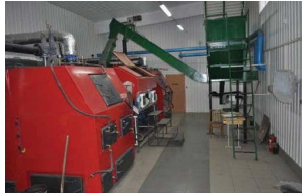
Рисунок 2.20 – Зовнішній вигляд теплогенеруючого обладнання котельні в м. Кам'янці-Подільському
