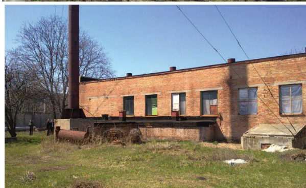
Рисунок 2.15 – Опалювальна котельня ОКВПТГ «Миргородтеплоенерго» за адресою: пров. Спартаківський, 8, м. Миргород
