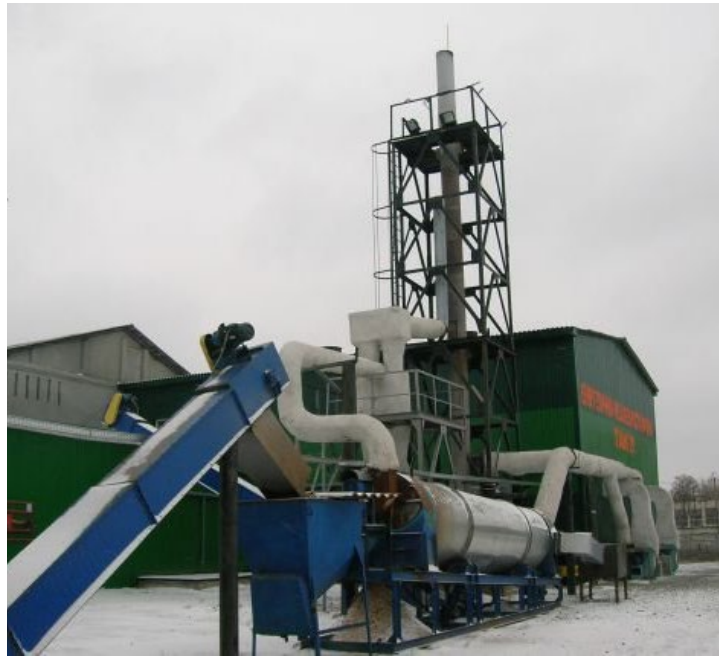
Рис. 4.8. Котельня на біомасі ДМП «Івано-Франківськтеплокомуненерго».
