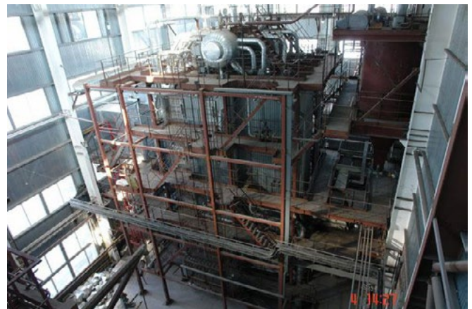
Рис. 4.5. Котел E-16-3,9-360-Д на ТЕЦ «Кіровоградолії».
