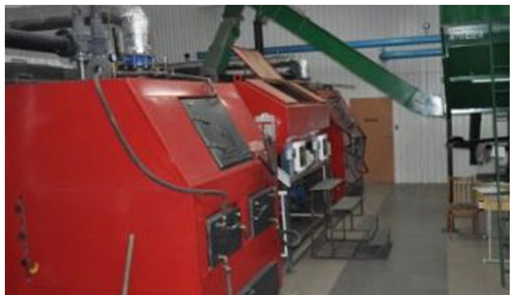
Рис. 4.11. Котельня на біомасі КП «Міськтепловоденергія» (м. Кам'янець-Подільський).
