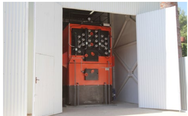
Рис. 4.6. Котельня з котлом КВм-2,5 ТОВ Крігер Енергія.
