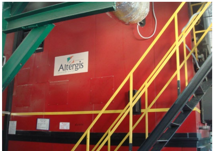
Рис. 4.9. Котельня на біомасі КПТМ «Черкаситеплокомуненерго».
