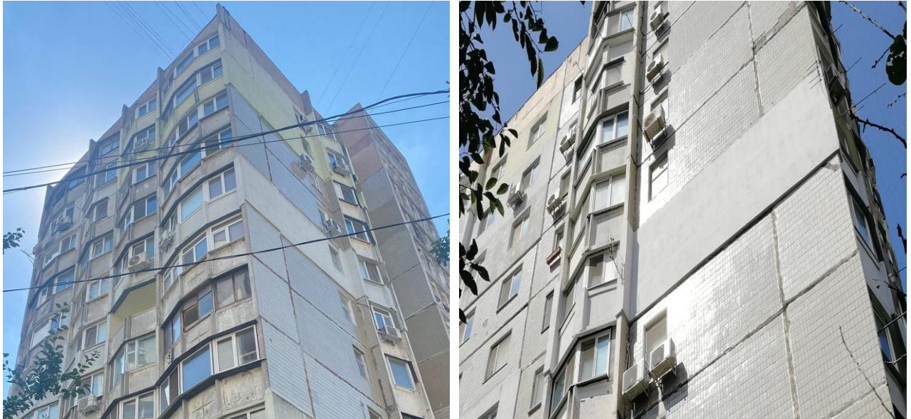
Рис. 4.4 Приклади латкового утеплення стін
