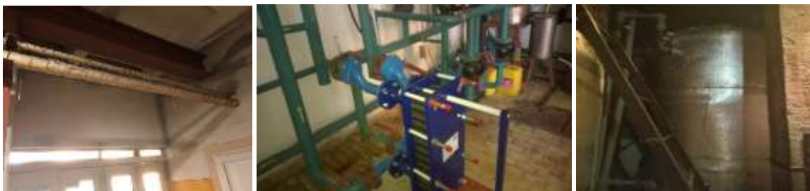
Термоізолювані труби, новий теплообмінник, новий термоізолюваний бак-накопичувач (ГВП)
